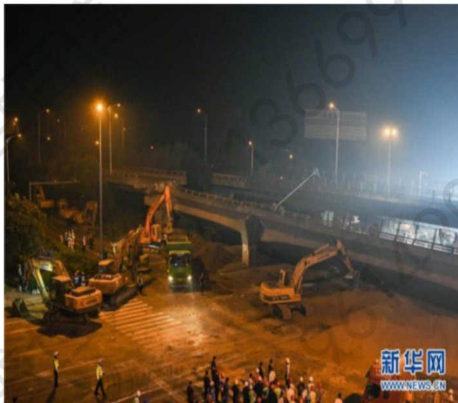
无锡312国道跨桥1010事故
